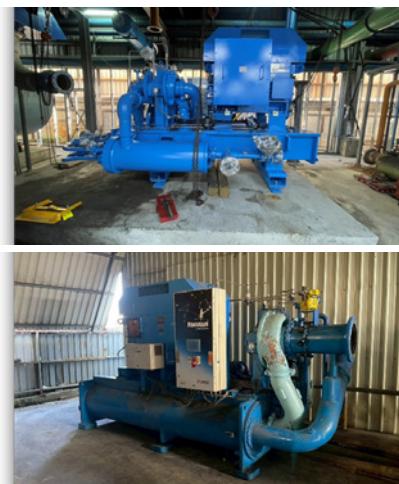
圖 2. 原 1100kW 空壓機 VS 新 800kW 空壓機。
